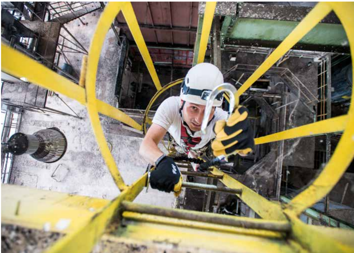
Maintenance inside the Zaharul Oradea SA sugar plant. Mantenimiento en el interior de la fábrica de azúcar de Zaharul Oradea SA. Oradea, Romania (courtesy of Camp Technical Solutions, ph. Riky Felderer).
